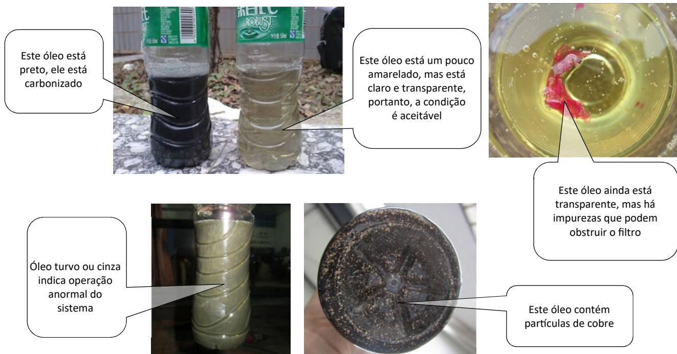
Figura 63: Inspeção do óleo do compressor
